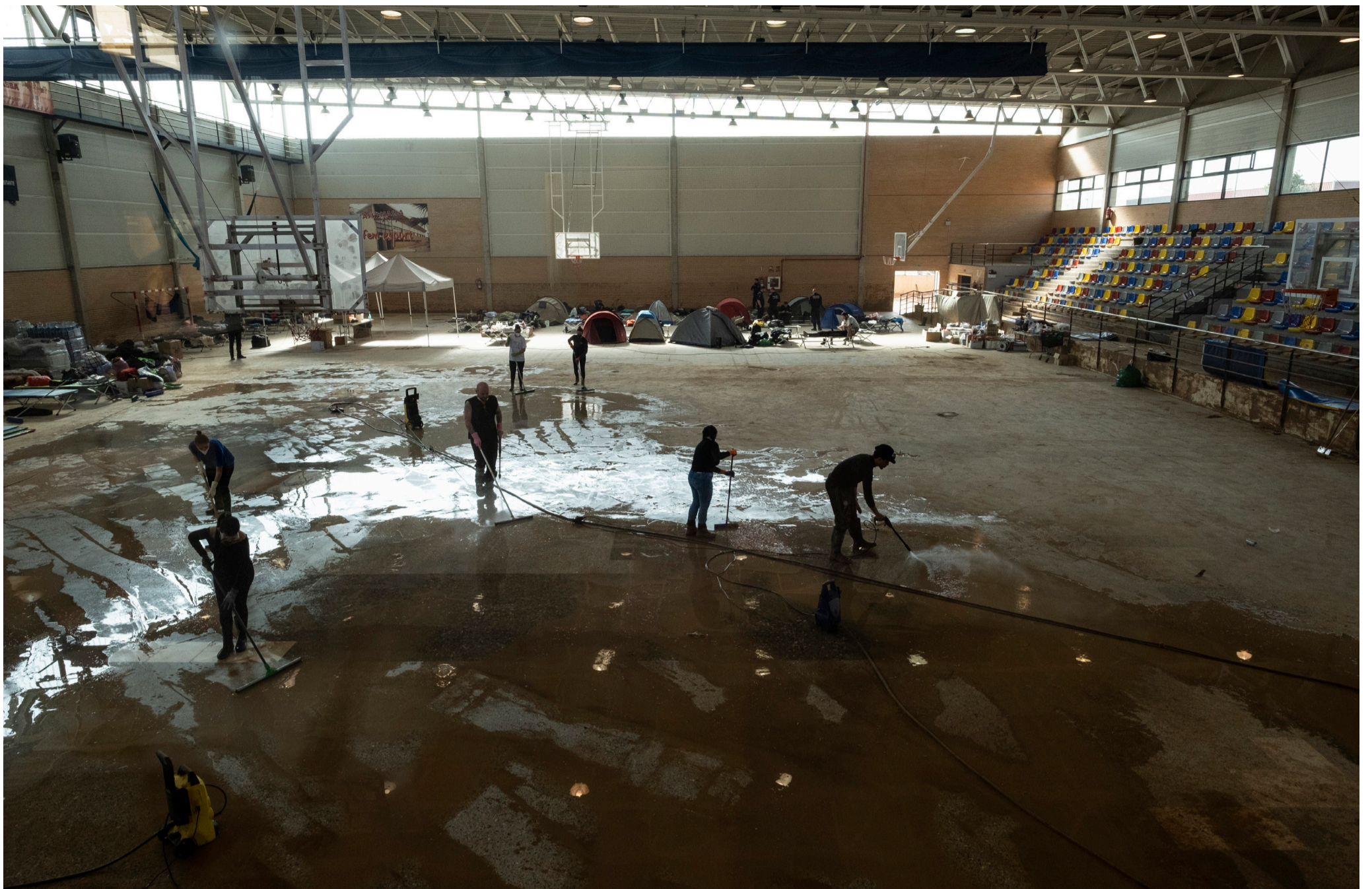
Tareas de limpieza y acondicionamiento del polideportivo de Massanassa, inundado durante la DANA, donde el agua llegó a alcanzar casi 2 metros de altura, como se aprecia en las marcas en la pared. Ahora, trabajan para que, en unos días, se convierta en un campamento base donde se instalarán miembros de diferentes fuerzas de seguridad que han acudido como voluntarios.
