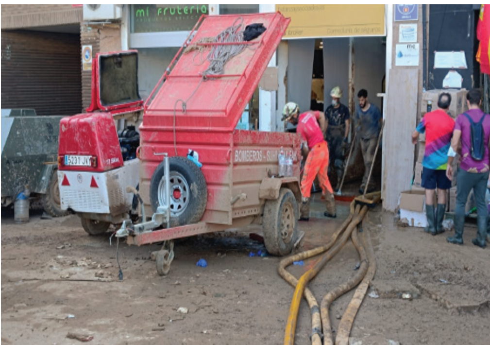
Un bombero Navarro vacía un local lleno de lodo en Paiporta. FOTO: CEDIDA
